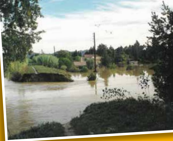
Une des 6 brèches en 2006. source Didier Bondut
